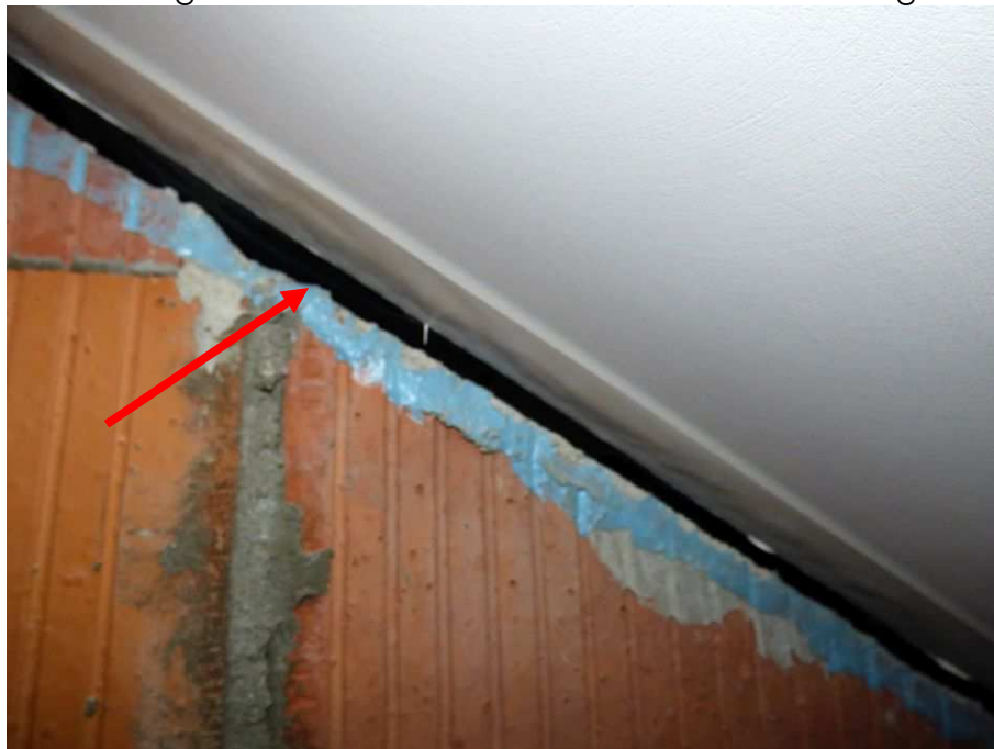
Bild 13 – Fugen zwischen Mauerwerk und Dachverkleidung ist fachgerecht zu schließen
