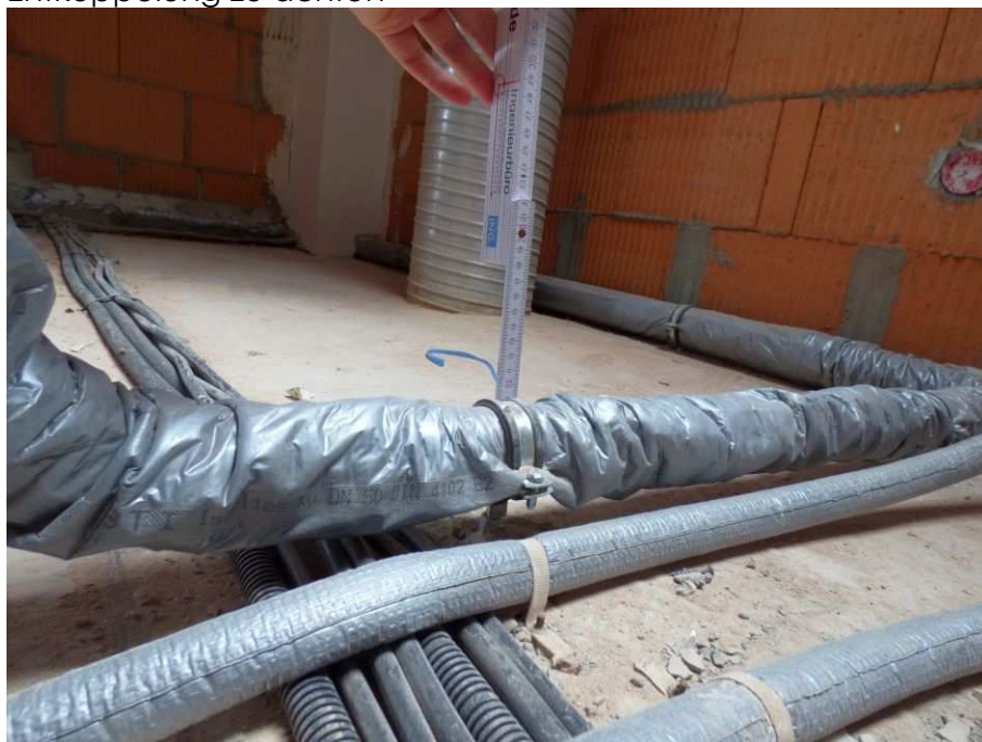
Bild 10 – Es ist auf ausreichende Überdämmung der Leitungen zur schalltechnischen Entkopplung zu achten
